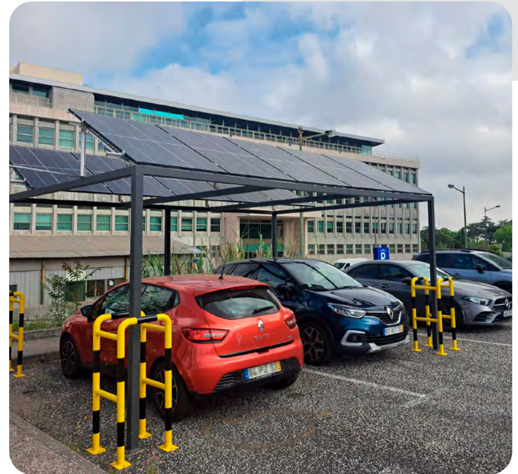
Marquesinas fotovoltaicas en Saba Palácio da Justiça (Lisboa)
