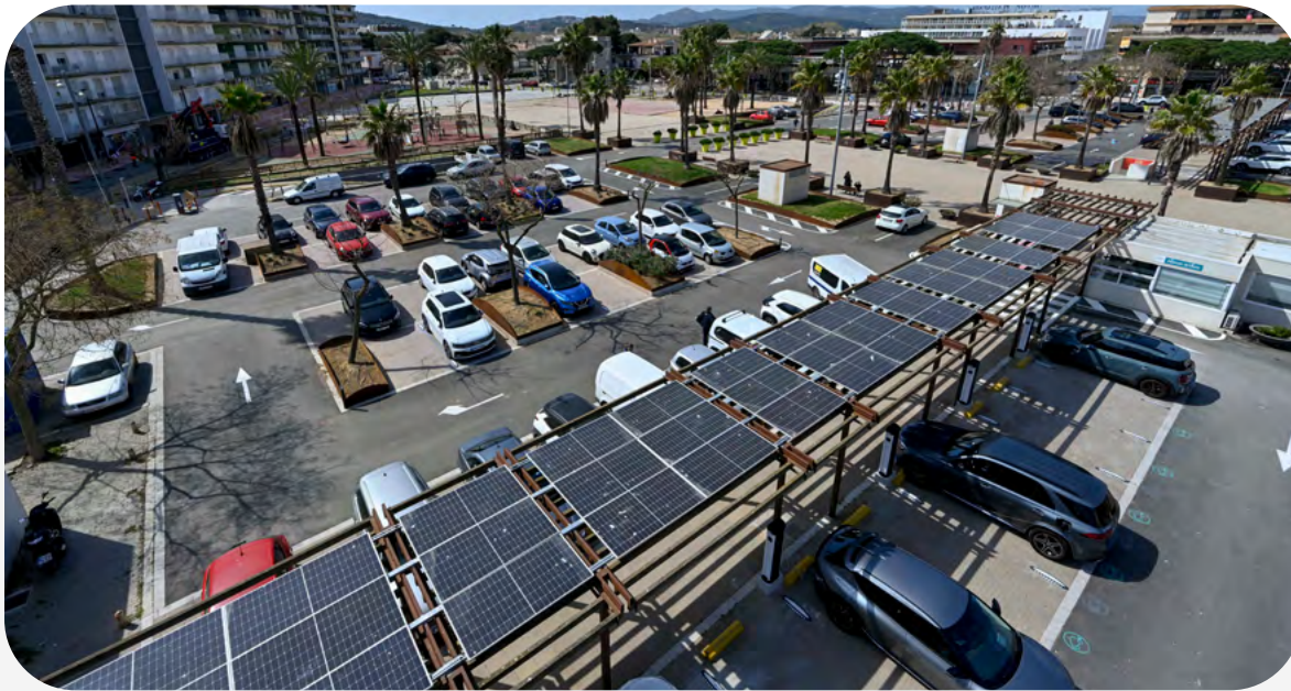
Photovoltaic canopies at Saba Hospital de Sant Pau (Barcelona) and Saba Pl. d'Europa, Platja d'Aro (Girona).
